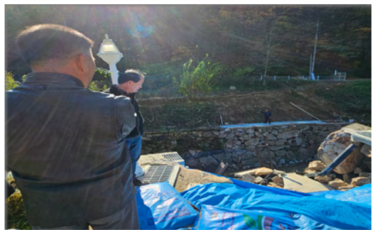
▲ 옹벽 붕괴 민원 현장 [2025.11.19.]
