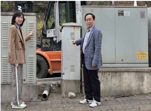
공공분양주택지 인접 배전설비 이설 관련
